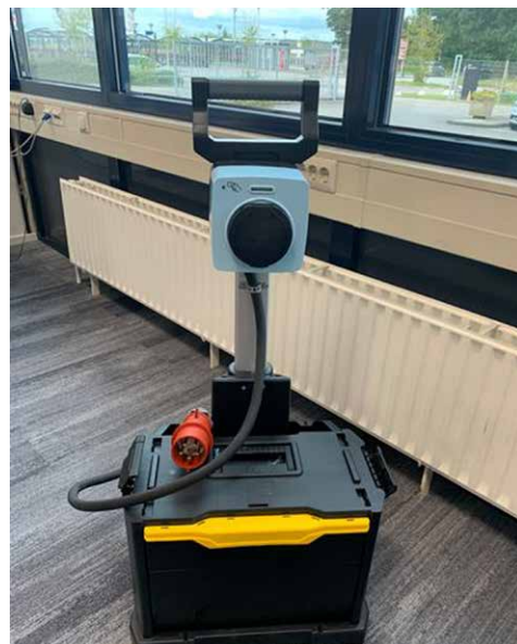
Figuur 11; Mobiel oplaadstation.
